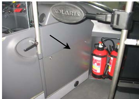
Rys. 15.2 Szafka po prawej stronie miejsca kierowcy (wskazana strzałką – dostęp do płyty elektrycznej T1)
